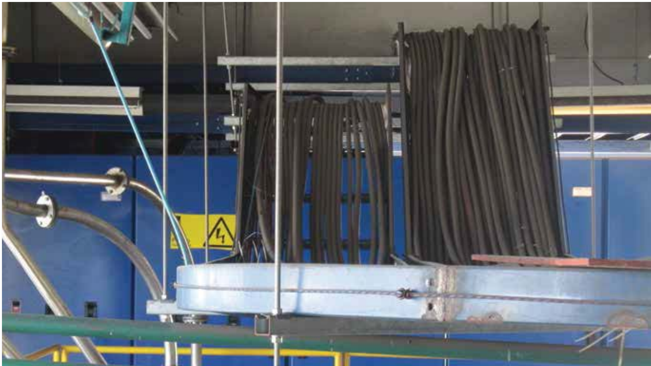
Instalación fija en la que se aprecia la gran flexibilidad de los cables SUPERFLEX/EVA.
