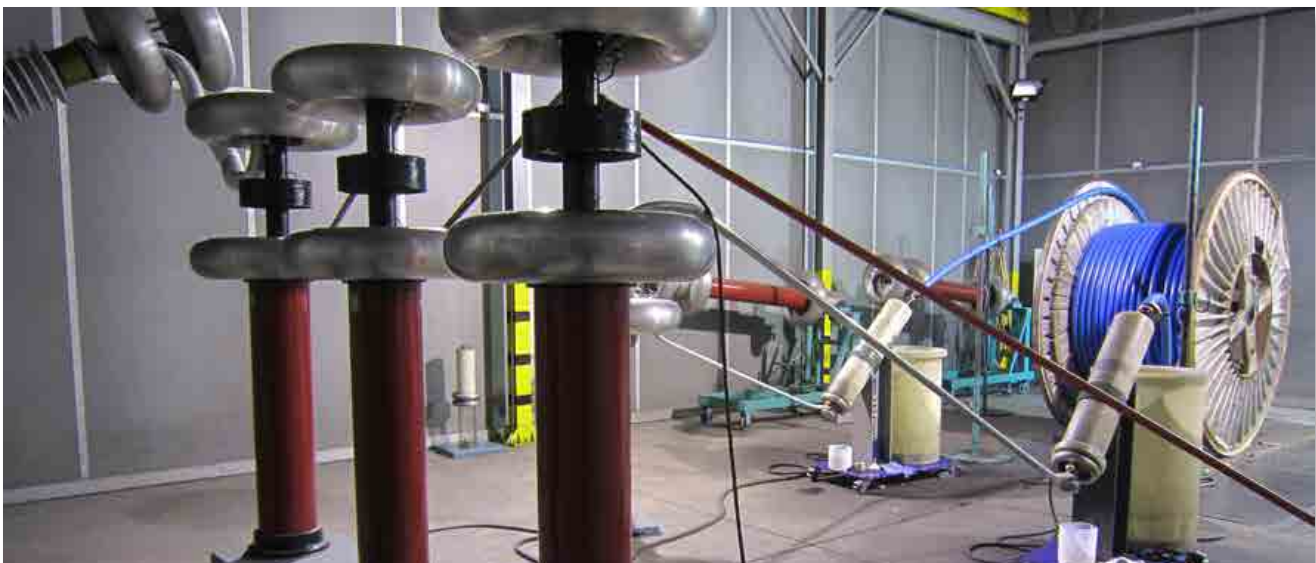
Pruebas de calidad aplicadas a cables de media y alta tensión en la jaula de Faraday de la planta de Cerrillos.
